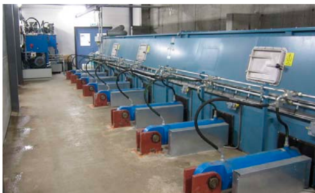
Statkrafts fjärrvärmeanläggning i Trosa.
